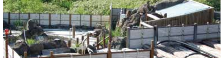
撤去されずに廃墟然とした姿をさらす露天風呂 2021年6月28日撮影
